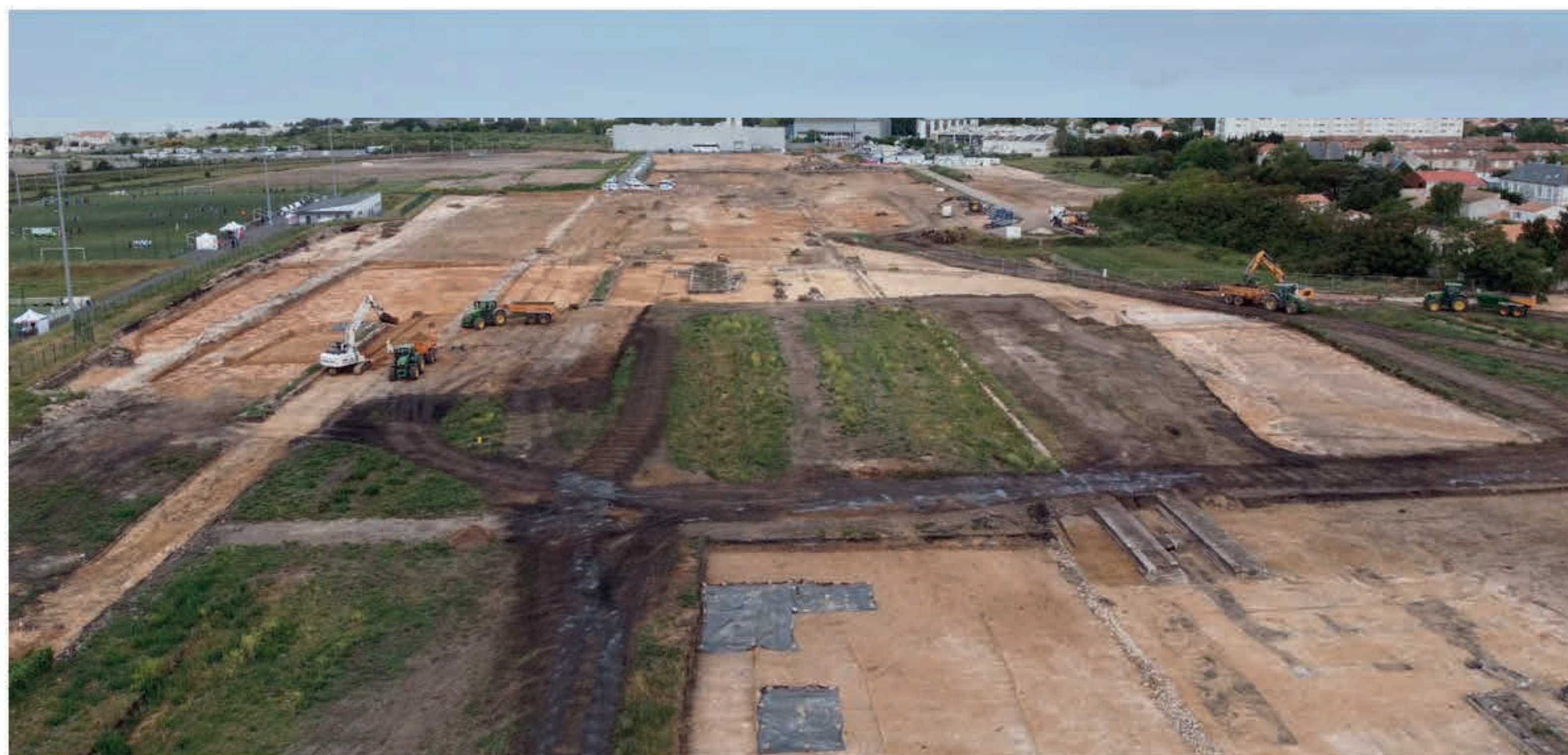
Vue aérienne du site au cours des travaux de dépollution en 2022 - photo : © EODD
